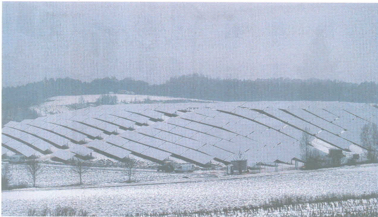
Nue im Landkreis Neu-Ulm: Der Solarpark Bellenberg macht Strom aus Sonnenlicht. Am Freitag soll der Park ganz offiziell in Betrieb genommen werden.
